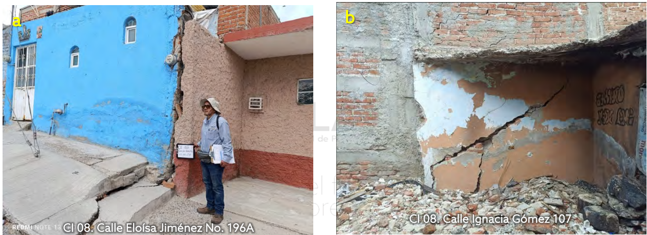
Figura 3.18. a) Abertura de muros colindantes y b) fracturamiento de muros en viviendas. Fuente: Elaboración propia en recorrido de campo.
