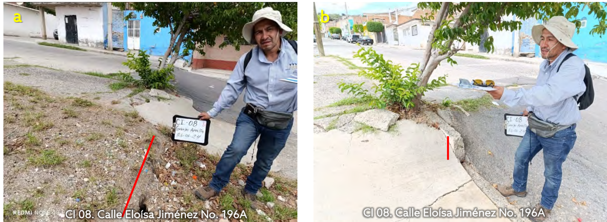
Figura 3.17. a) Dirección de la grieta y b) hundimiento. Fuente: Elaboración propia en recorrido de campo.
