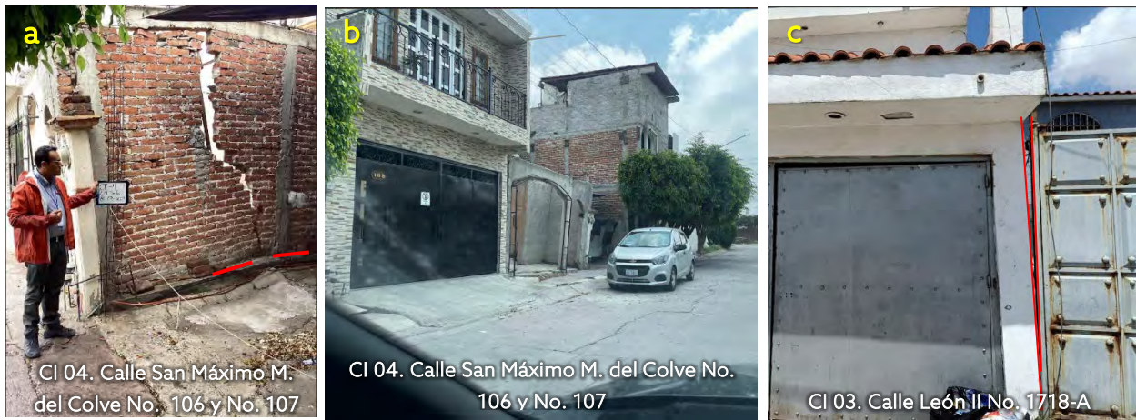
Figura 3.11. a) Fractura en muro, b) sobrecarga frontal y c) inclinación de edificación. Fuente: Elaboración propia en recorrido de campo.
