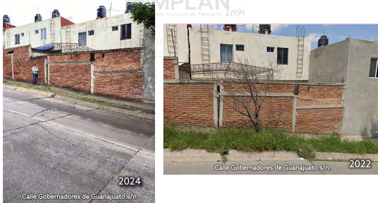
Figura 3.36. Fracturamiento en muro y separación en columnas de 2022 a 2024 para el punto CI-21. Fuente: Elaboración propia en recorrido de campo y de Google Maps.
