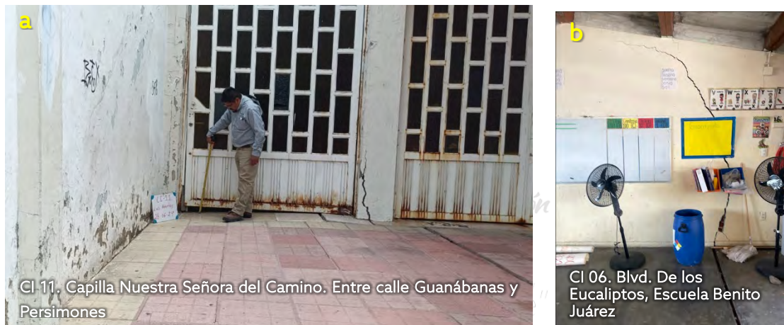
Figura 3.16. a) Fracturamiento en columnas, muro e inclinación de la Capilla de Nuestra Señora del Camino y b) separación de bloques en piso y fractura en muro, escuela primaria Benito Juárez. Fuente: Elaboración propia en recorrido de campo.
