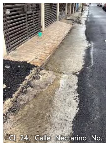
Figura 3.27. Calle Nectarino, recién pavimentada, estaba partida por el agrietamiento.
