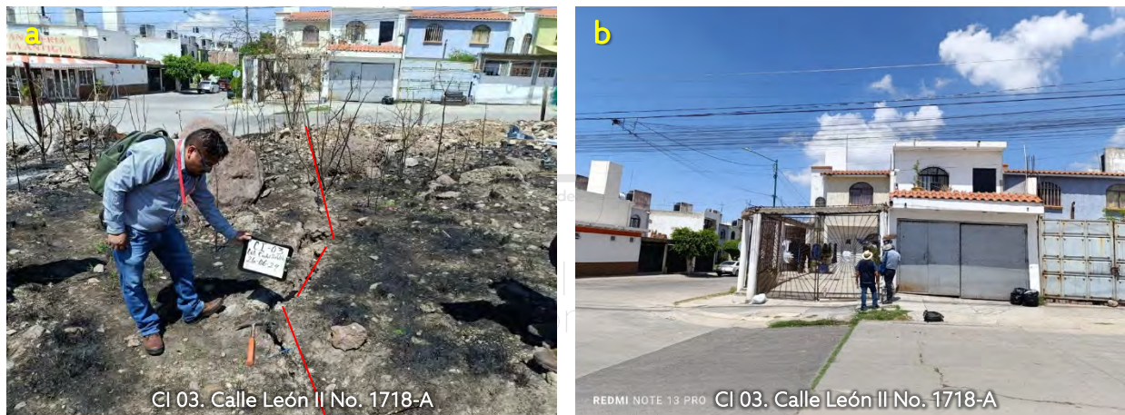
Figura 3.12. a) Grieta en camellón y b) continuación de la traza de la grieta en camellón. Fuente: Elaboración propia en recorrido de campo.
