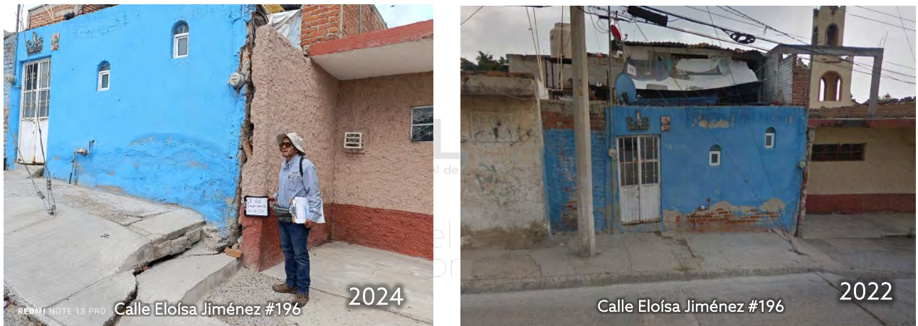
Figura 3.32. Fracturamiento y hundimientos del 2022 y 2024 para el punto CI-08. Fuente: Elaboración propia en recorrido de campo y de Google Maps.
