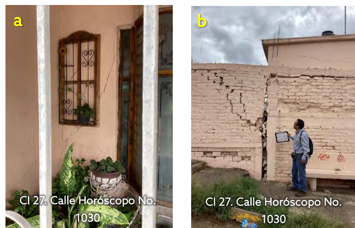
Figura 3.29. Fracturamiento de a) muros y b) bardas. Fuente: Elaboración propia en recorrido de campo.
