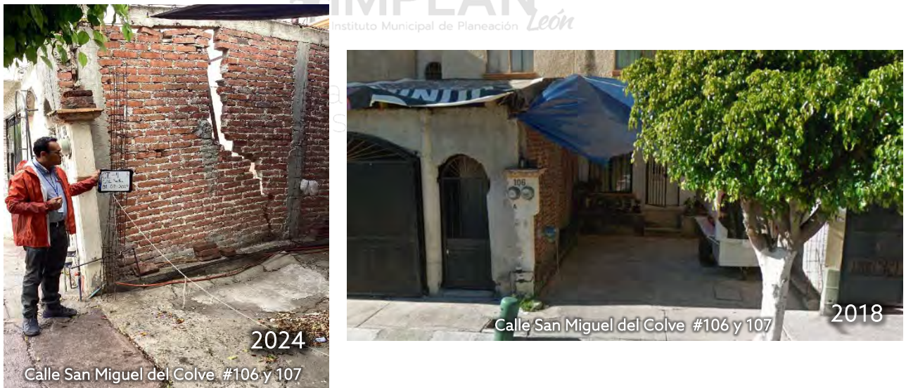
Figura 3.35. Fracturamiento en muro de 2018 a 2024 para el punto CI-04. Fuente: Elaboración propia en recorrido de campo y de Google Maps.
