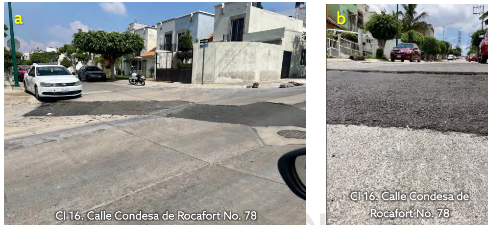
Figura 3.22. Hundimiento en la colonia La Condesa. Fuente: Elaboración propia en recorrido de campo.
