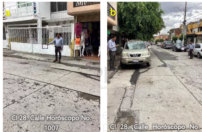
Figura 3.28. a) Hundimiento, b) fracturamiento y separación de bloques de pavimento Fuente: Elaboración propia en recorrido de campo.
