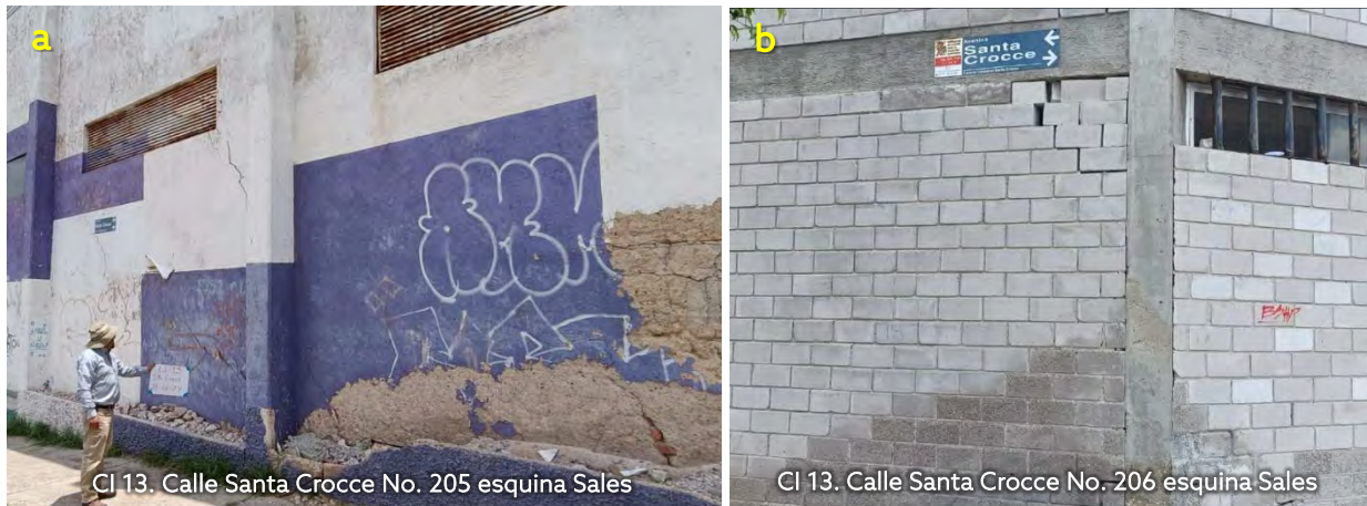
Figura 3.19. Fracturas en a) muros y b) columnas. Fuente: Elaboración propia en recorrido de campo.
