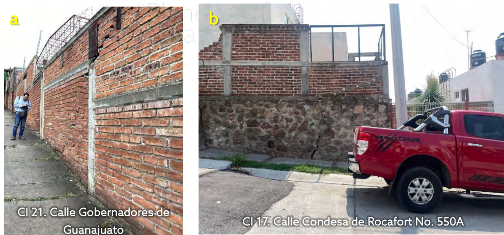
Figura 3.23. Fracturamiento en a) barda perimetral de la colonia y b) barda perimetral de vivienda afectada. Fuente: Elaboración propia en recorrido de campo.
