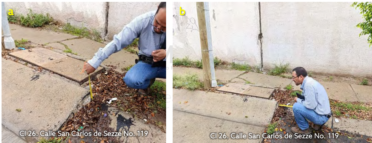
Figura 3.21. a) Hundimiento y b) separación de pavimento.
