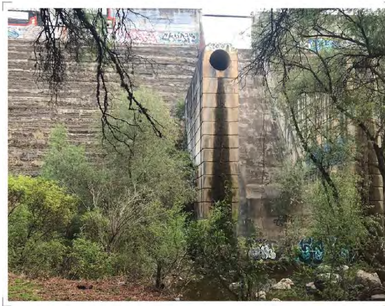
Imagen 32. Cortina de la presa de la manzanilla, para el día 15 de julio del 2022 presenta un bajo nivel de agua y un leve escurrimiento de las alcantarillas de la parte posterior a la cortina.
